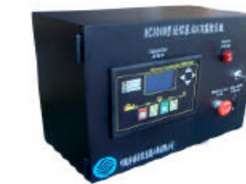
Auto Generator start/GSM
